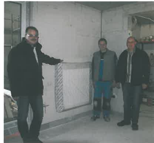
Im Rohbau: Für Jürgen Schwarz (links) und seine Mitarbeiter Herr Berg (Mitte) und Herr Greiner gestaltet sich die Arbeit mit dem Stelrad-Heizkörper „Novello Eco“ problemlos. (Foto: HeizungsJournal)
